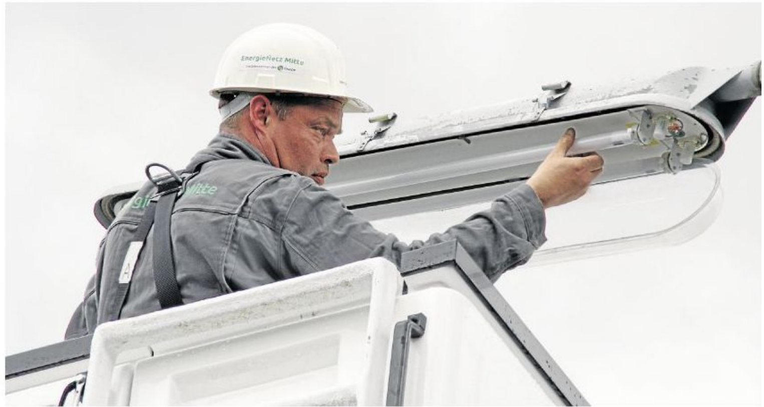
Ein Mitarbeiter der EnergieNetz Mitte tauscht vor dem Flammersfelder Rathaus eine Leuchtstoffröhre gegen ein LED-Leuchtmittel aus.
